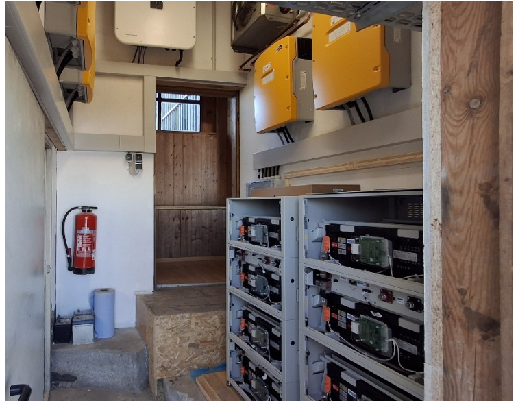
Technikraum mit Batteriespeicher und Wechselrichter
